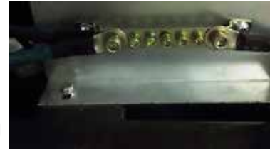
Generator Grounding Bar Lug
