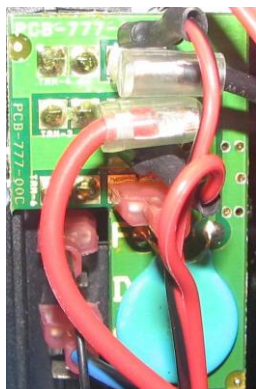
LOAD DUMP Module
